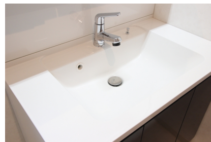
洗面台の排水
